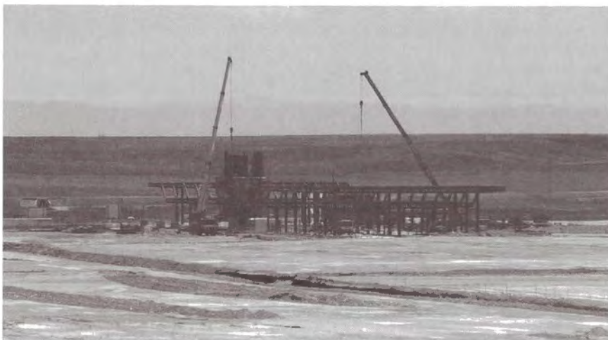
Obres de construcció de la terminal de l'aeroport de Lleida-Alguaire. Foto: Àlex Tarroja
