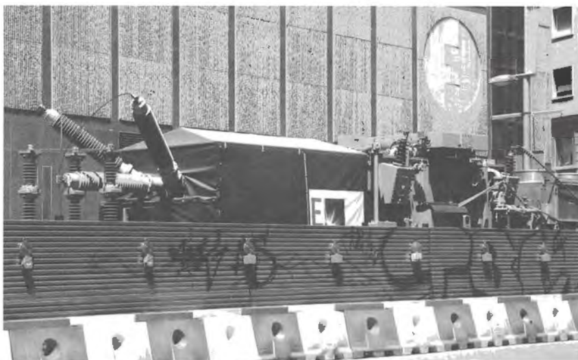
Detall de la subestació elèctrica de Maragall Foto: Àlex Tarroja
